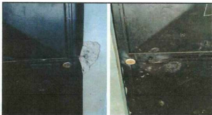
Foto 3: Se observa chapas de puertas en mal estado: Se necesita cambio de chapas de puertas de aulas y de baños, llaves en mal estado y con solo una copia.
