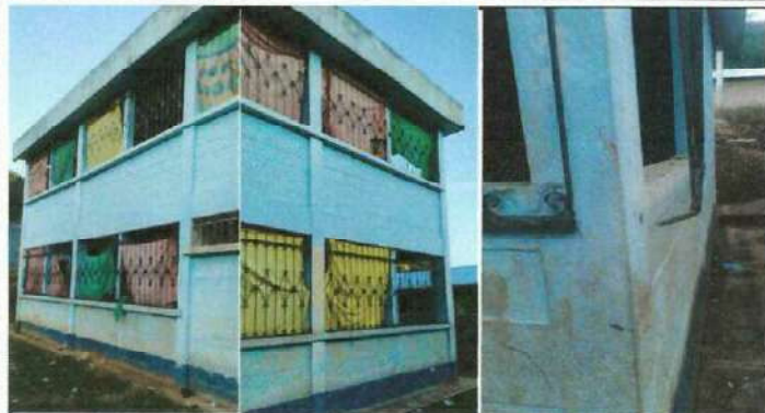
Foto1: Se observa dislocación y oxidación de balcones: necesita reparación, reforzamiento y pintura en su estructura metálica.
