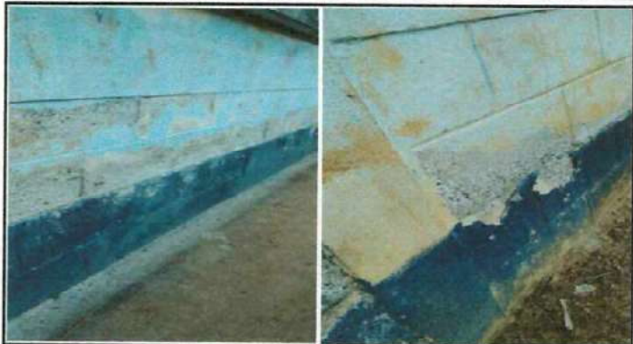
Foto 1: Se observa deterioro de block: Necesita colocación de cernido
