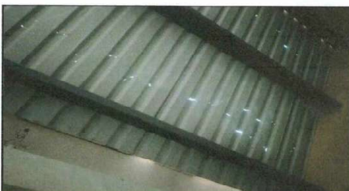
Foto 4: Se observa perforaciones en laminas de la Dirección: Necesita cambio de láminas troqueladas.
