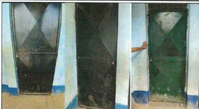
Foto 2: Se observa deterioro de pintura y oxidación de puertas, necesita colocación de pintura anticorrosiva. (11 puertas)
